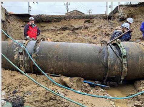
＜地震による送水管の損傷＞
