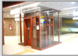
エレベーター
